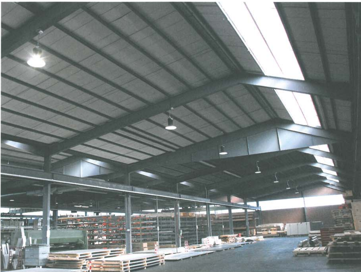
LCC-Hallenstrahler 200 Watt ersetzen 400-Watt-Entladungslampen, und die Beleuchtungsstärke ist um 50 Prozent gestiegen.
